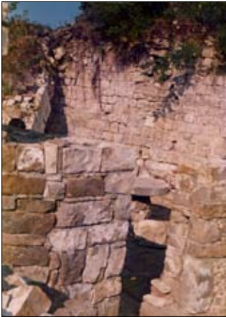
Tav. V, 1. Dettaglio con il crollo di parte della parete settentrionale del mastio (foto messa a disposizione dal sig. Cencig).
