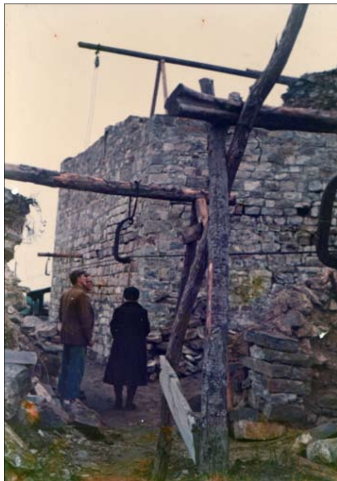
Tav. VI, 2. Dettaglio della teleferica, al momento in cui la ricostruzione del mastio è già da tempo avviata (foto messa a disposizione dal sig. Cencig).
