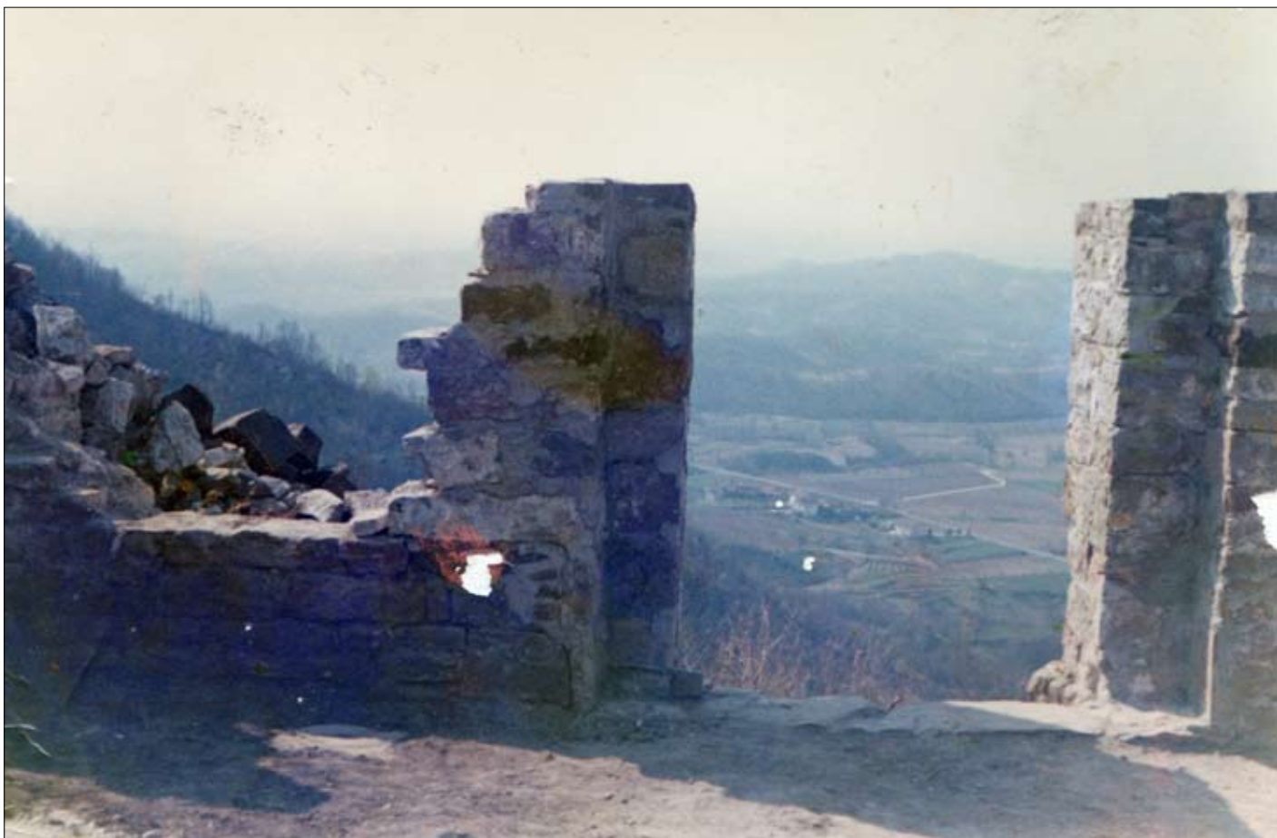
Tav. XI, 2. Gli stipiti dell'attuale accesso e il muro nella sua forma prima degli interventi degli anni Settanta (foto messa a disposizione dal sig. Cencig).
